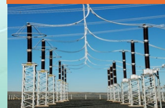
Subestações ate 800kV
