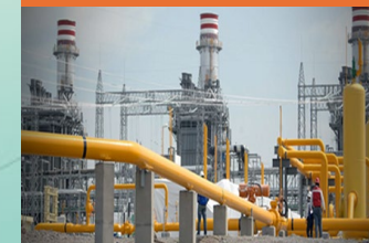
Termicas, UTGs e Gasodutos
